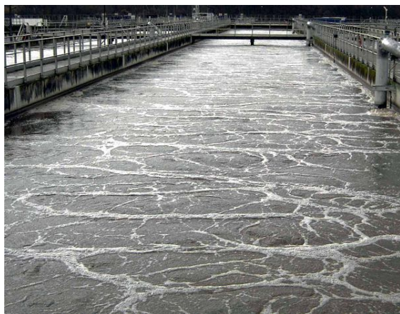
Impianto a fanghi attivati con microbolle.
